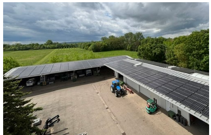
Neue PV-Anlage auf der Technikhalle/ Werkstatt am Standort Bad Lauchstädt. Foto: Konrad Kirsch (UFZ)
