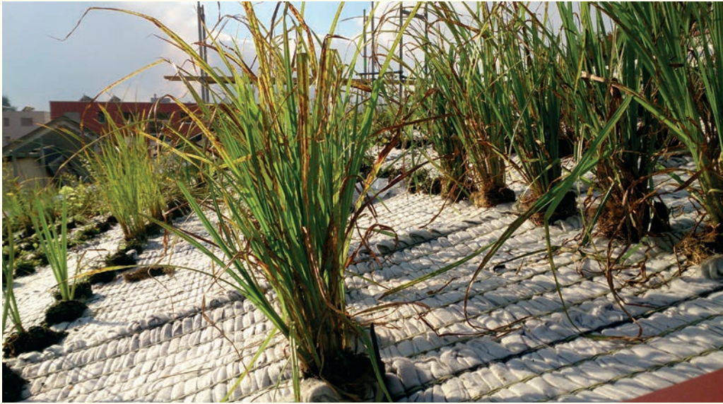
Abb. 9: Das Sumpfpflanzendach in Zofingen kurz nach der Erstbepflanzung durch die Firma Rhizotech (Foto: M. Blumberg).
