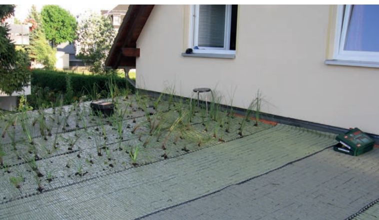
Abb. 4: Aufbau der Dachschichten (Teerpappe, Gewebeplane, später ersetzt durch PVC-Teichfolie, textiler Vegetationsträger) und erste Bepflanzung mit Topfballenpflanzen im August 2008 (Fotos: Mählmann).
