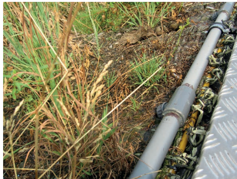
Abb. 3: Wasserversorgung der Sumpfpflanzen auf dem Dach (Detailaufnahme), (Foto: H. Georg).
