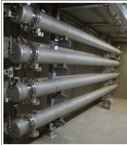
Abb. 1: Reaktoren 1 - 4 im Reaktorraum der Anlage
